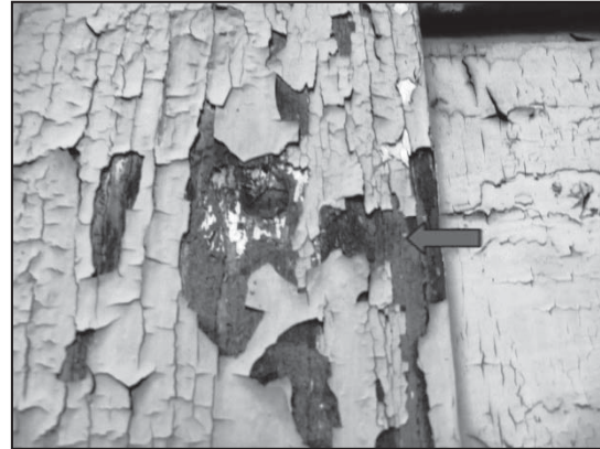
2) 窓枠に残存する緑色塗装痕跡
